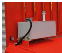
Centrale hydraulique pour le tapis de déchargement
